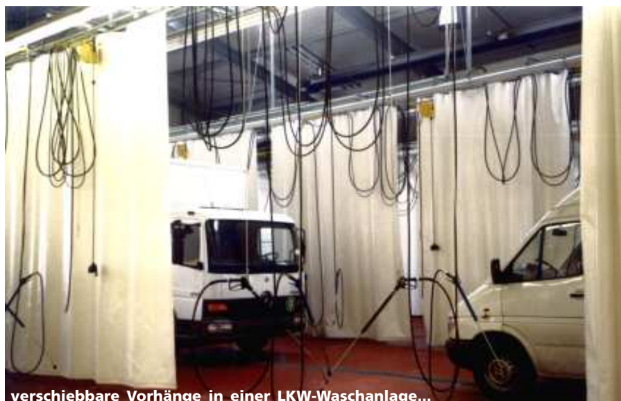
verschiebbare Vorhänge in einer LKW-Waschanlage...
