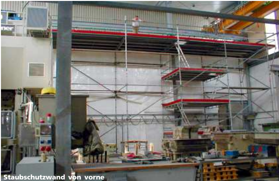
Staubschutzwand von vorne
